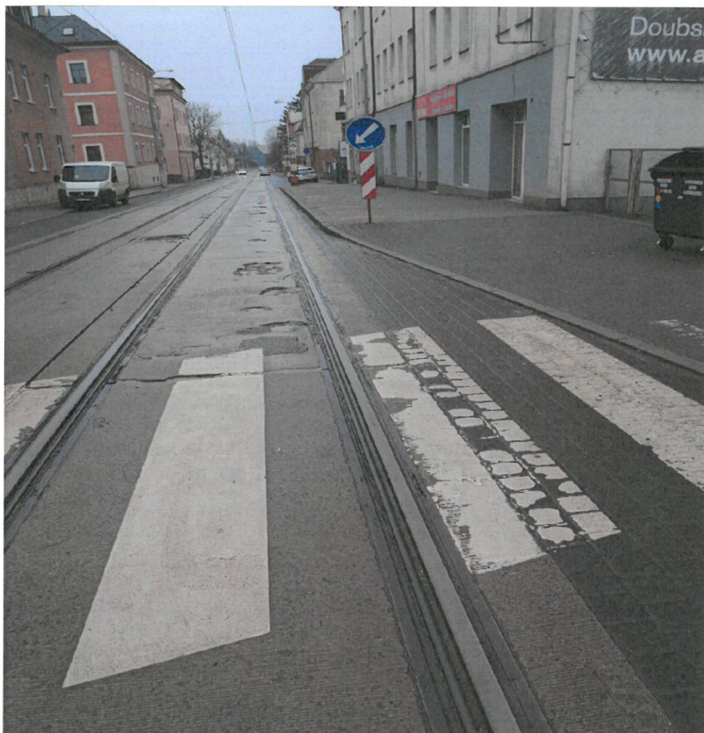
Poškozený povrch panelů ve spojení poškození rybin panelů BKV
