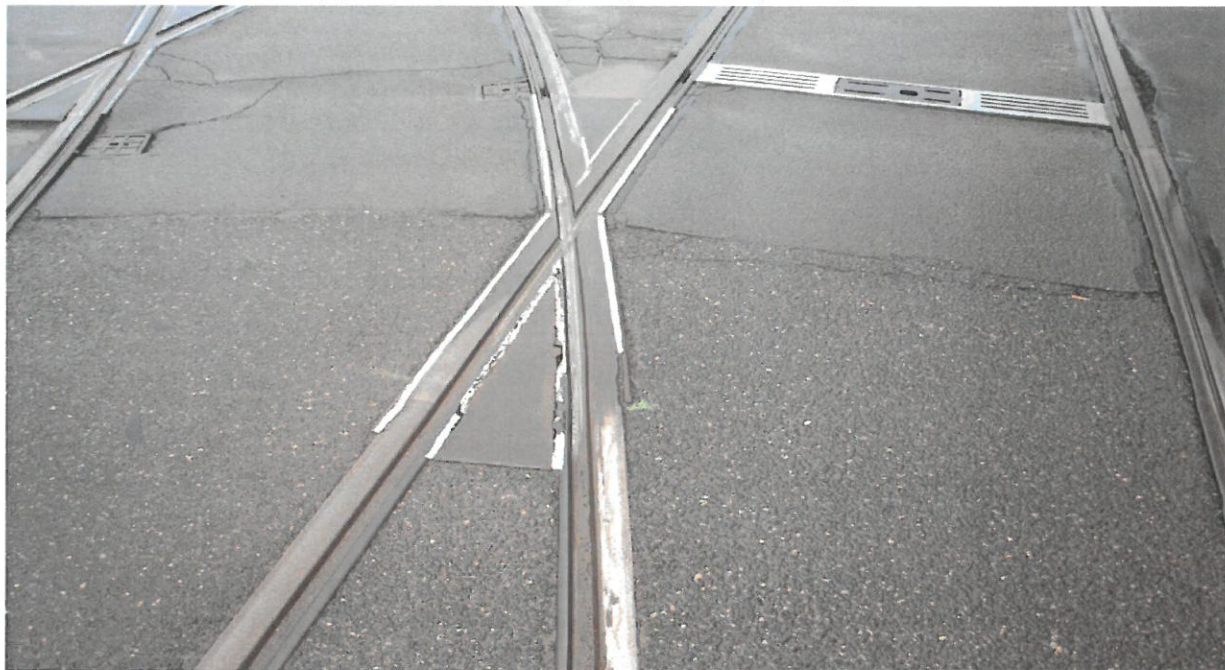
Příklad křížení značně bočně ojetého – provizorně opraveno navařením značného množství materiálu
