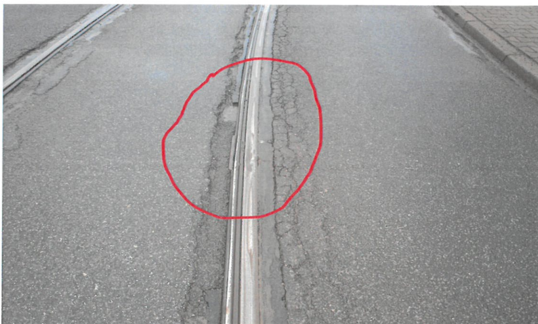
Provizorně opravená odlomená příruba kolejnice posílená navařením plochého železa
