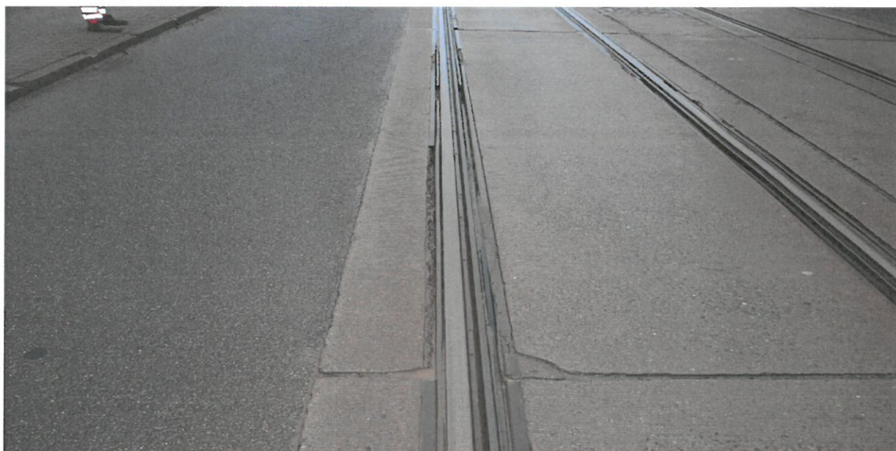
Příklad „propadlé“ rybiny panelu, při jízdě tramvaje pozorovatelný značný pokles kolejnice
