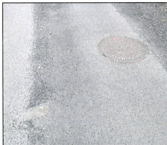
foto 6 inženýrské sítě umístěné v komunikaci
