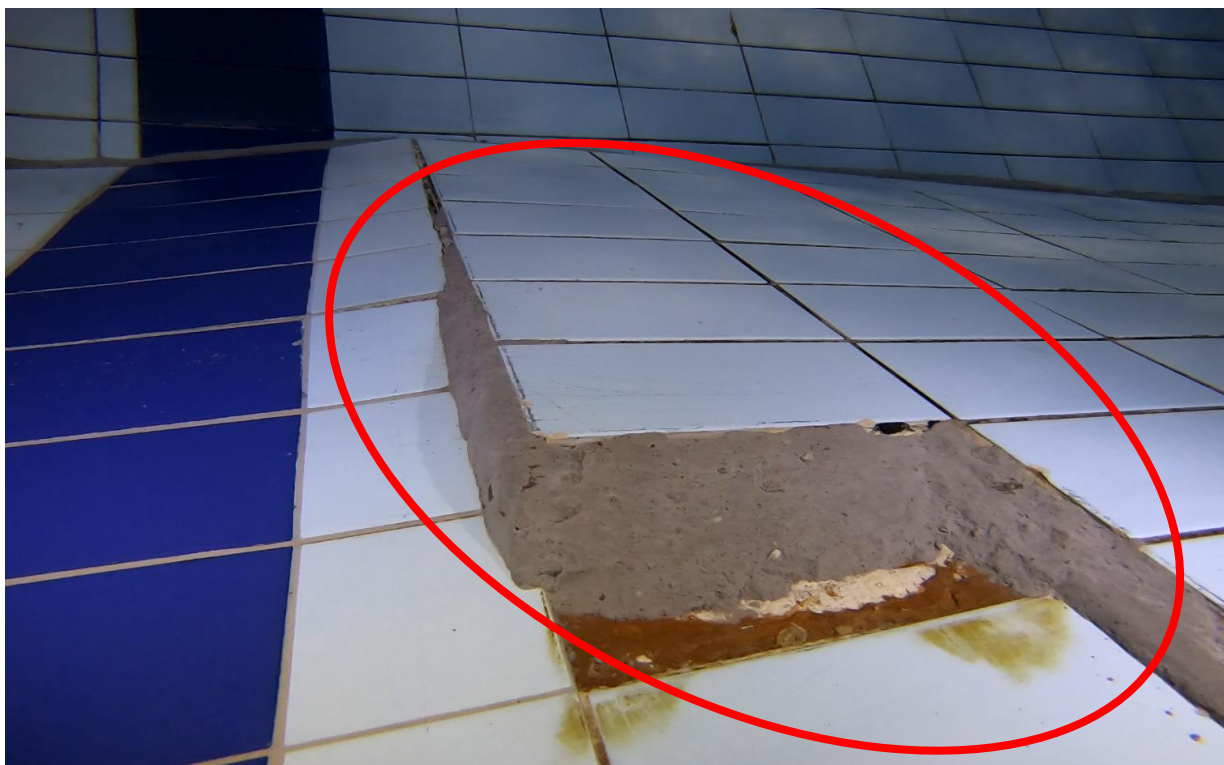
Obr. C-8 Detailní pohled na poškození dna plaveckého 50m bazénu a způsob provedení provizorní opravy.
