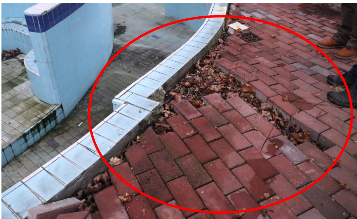
Obr. C-19 Detailní pohled na pokles povrchu terénu v okolí venkovní divoké řeky vlivem průsaku vody skrz železobetonovou bazénovou konstrukci.
