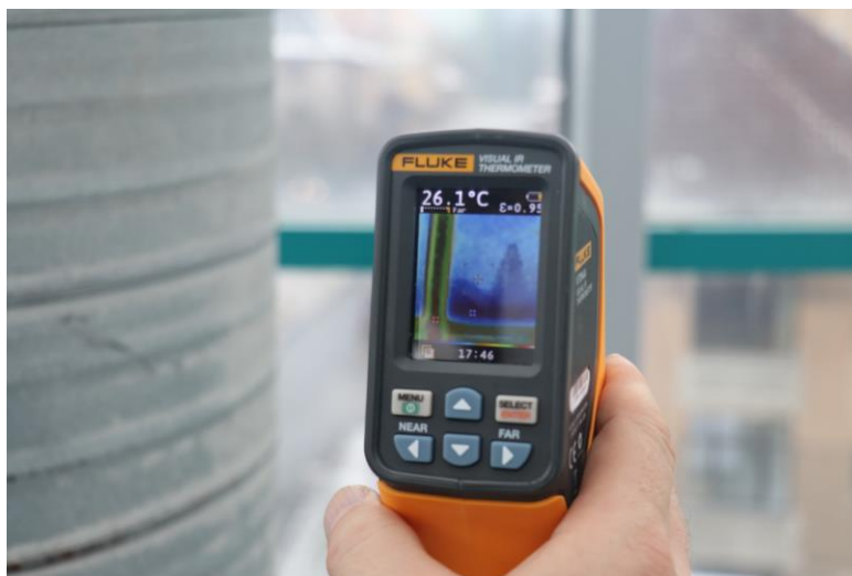
Obr. F-18 Kontrola teploty oken v nástupním prostoru na tobogán.
