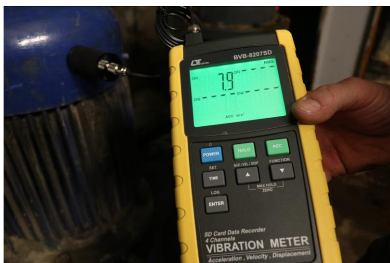
Obr. F-28 Kontrola vibrací recirkulačního čerpadla plaveckého 50m bazénu.
