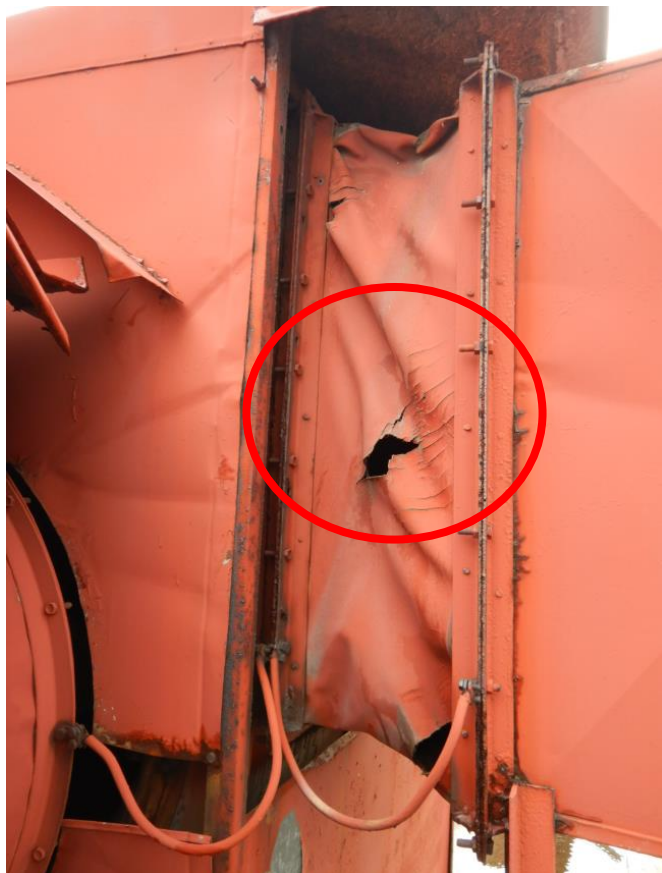
Obr. C-44 Pohled na poškození pláště vzduchotechnické jednotky umístěné na střeše MPB.
