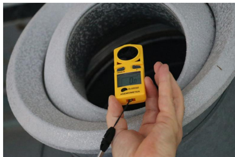
Obr. F-3 Kontrola proudění vzduchu z výdechů vzduchotechniky v prostoru dojezdu tobogánů.
