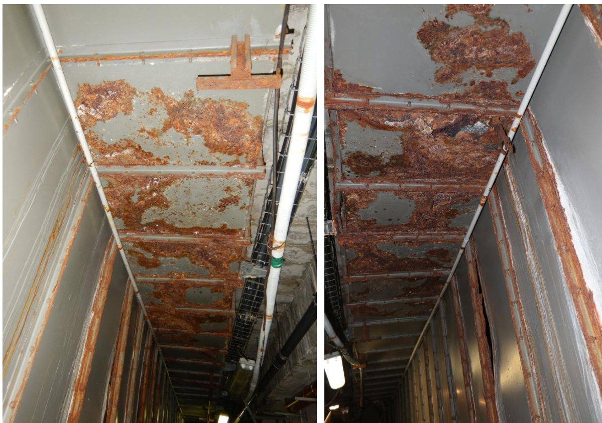
Obr. C-49 Pohled na rozsah poškození vzduchotechnických rozvodů rozsáhlou korozí.
