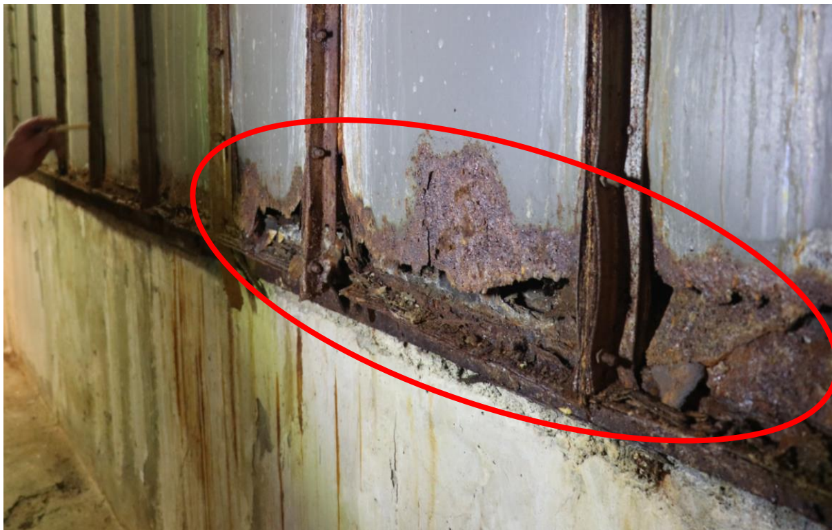
Obr. C-51 Detailní pohled na poškození vzduchotechnických rozvodů rozsáhlou korozi.
