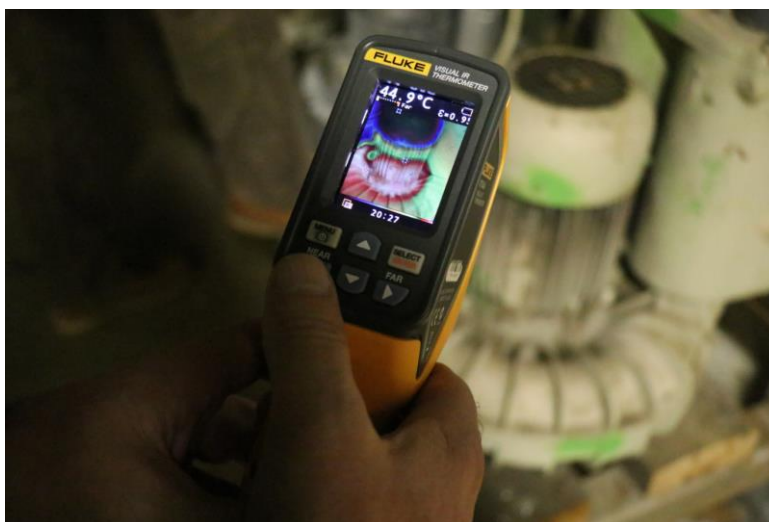
Obr. F-31 Kontrola teploty vzduchovače pro vířivku.
