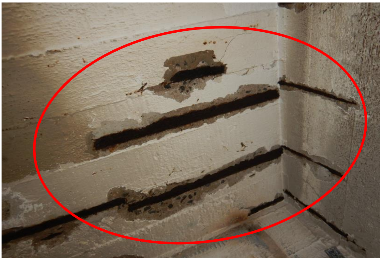
Obr. C-23 Pohled na nosnou vodorovnou železobetonovou konstrukci, která vykazuje korozi spodní výztuže.
