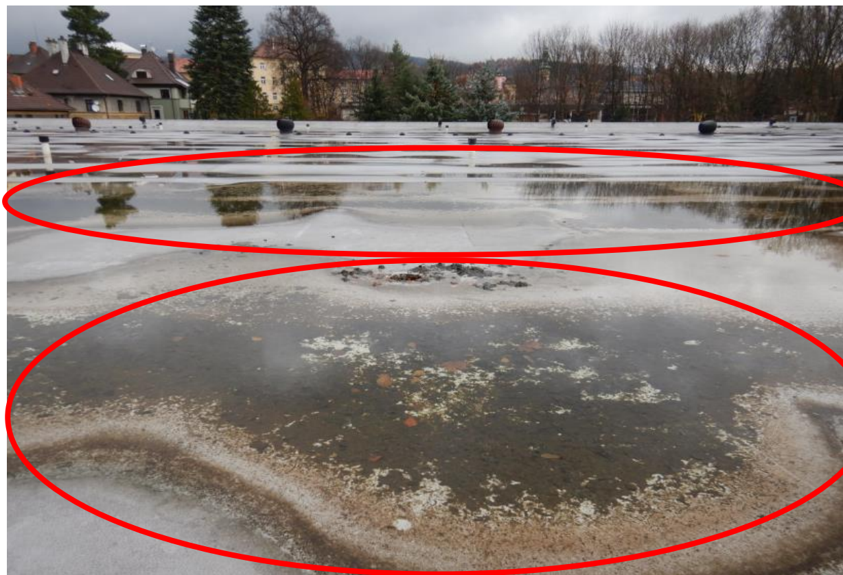
Obr. C-31 PVC krytina nad plaveckým 50m bazénem a stojící vodou a poškozenou konstrukcí.
