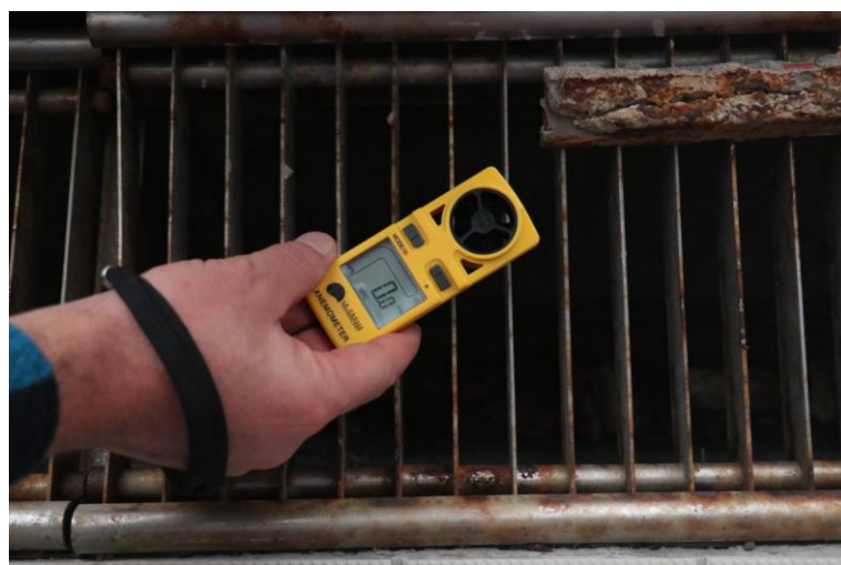
Obr. F-2 Kontrola proudění vzduchu z výdechů vzduchotechniky u východní prosklené fasády plaveckého 50m bazénu.
