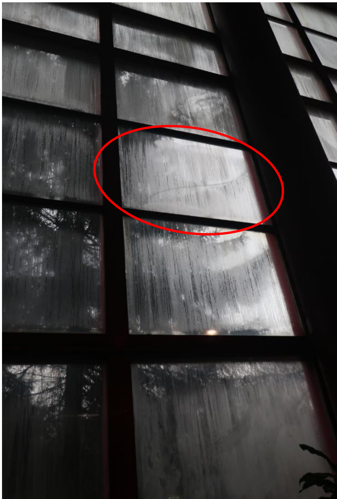
Obr. C-39 Pohled na prosklenou fasádu plaveckého 50m bazénu s poškozením a nefunkční vzduchotechnikou, kdy dochází k rosení oken a zatékání vody do konstrukce.
