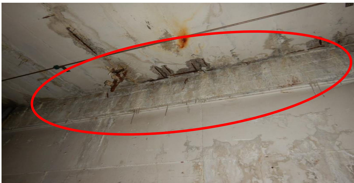
Obr. C-21 Pohled na nosnou vodorovnou železobetonovou konstrukci, do níž zatéká a vykazuje korozi spodní výztuže.
