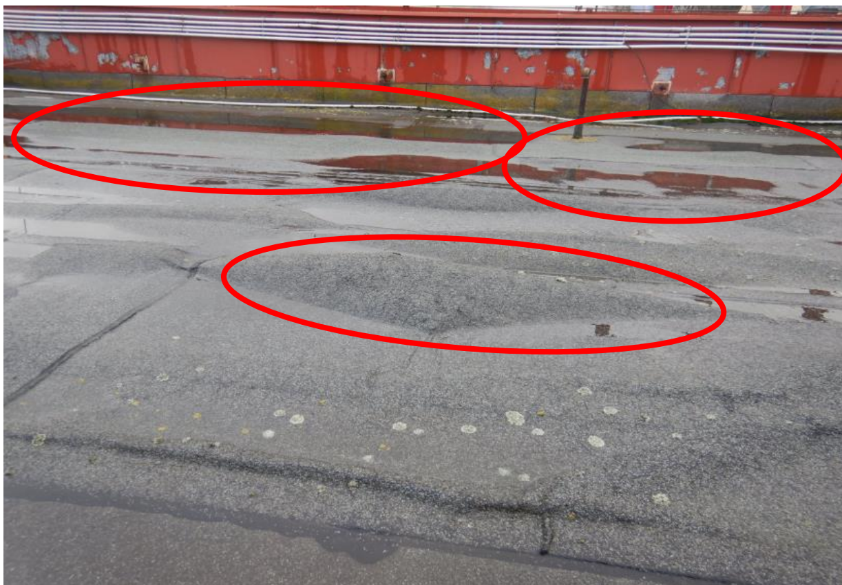
Obr. C-27 Pohled na plochou střechu s patrnými vzduťmi asfaltové krytiny a prohlubní se stojící vodou, která poškozuje povrch krytinu při mrazech v zimním období.
