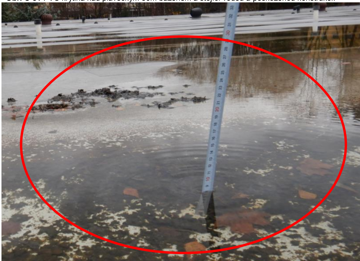
Obr. C-32 Detailní pohled na prohlubeň na střeše plaveckého 50m bazénu s PVC folií.
