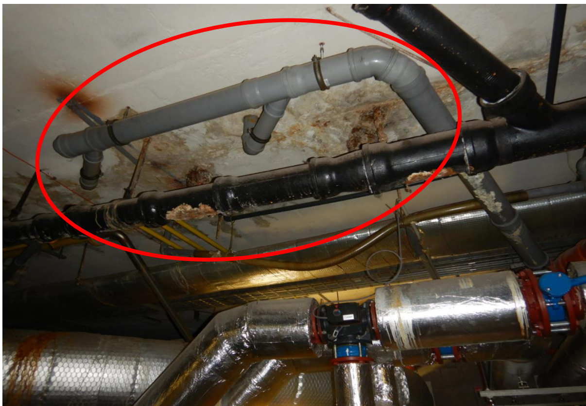
Obr. C-26 Pohled na průsak vody vodorovnou železobetonovou konstrukcí z prostor zázemí bazénového provozu.
