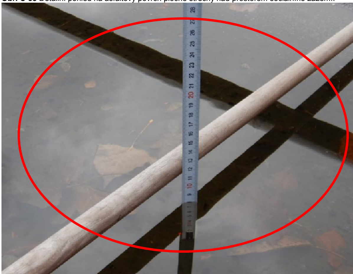
Obr. C-34 Detail hloubky v prohlubni ploché střechy, která dosahuje místy až 120 mm.
