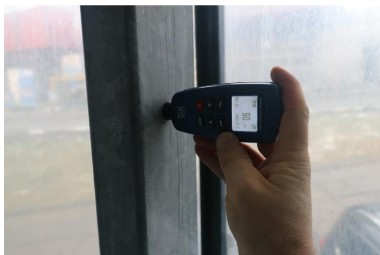
Obr. F-23 Kontrola tloušťky pozinkování okenní konstrukce v prostoru schodiště k tobogánům.
