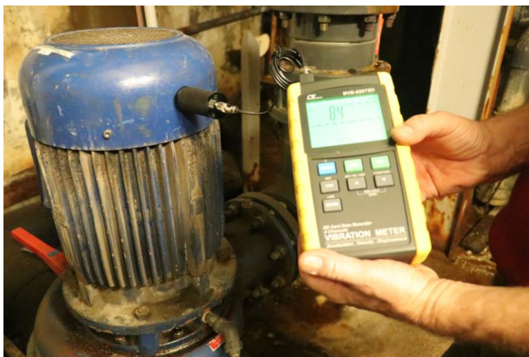
Obr. F-27 Kontrola vibrací recirkulačního čerpadla plaveckého 50m bazénu.
