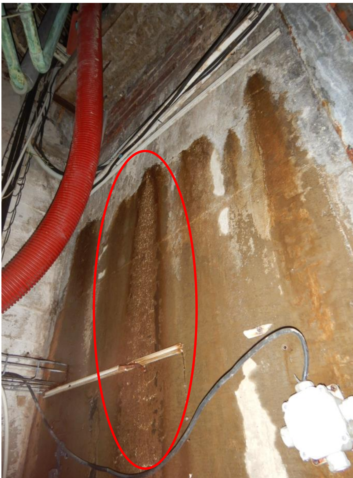
Obr. C-17 Pohled na průsak vody ŽB konstrukcí pod prostorem brouzdaliště.
