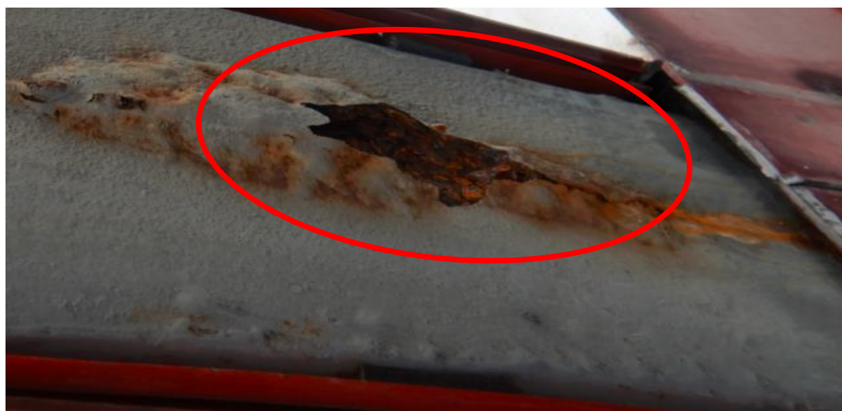
Obr. C-36 Detailní pohled na profil okenního rámu fasády plaveckého 50 m bazénu a projev koroze.
