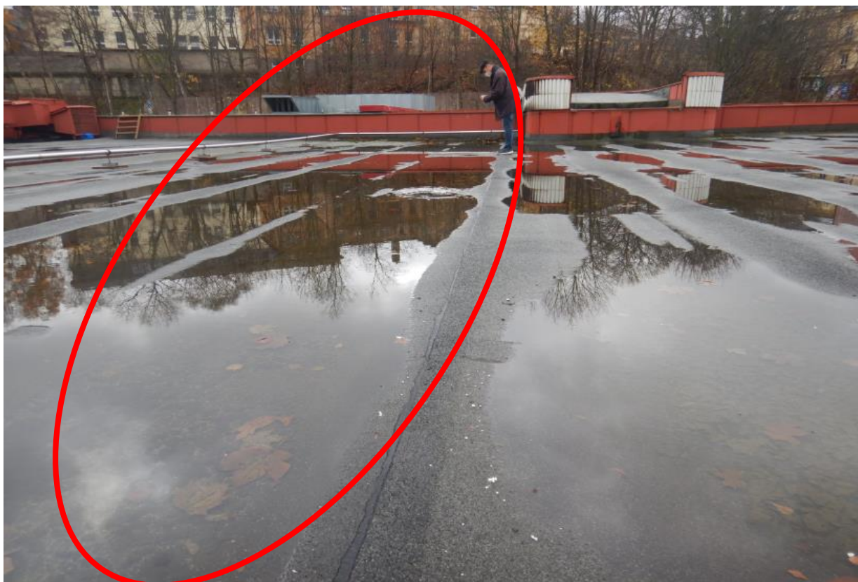
Obr. C-29 Pohled na plochou střechu s patrnými vzduťmi asfaltové krytiny a stojící vodou v prohlubních.
