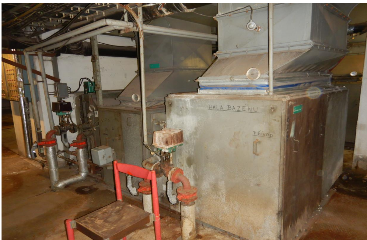
Obr. C-46 Pohled na stávající vzduchotechnické jednotky ve strojovně MPB.
