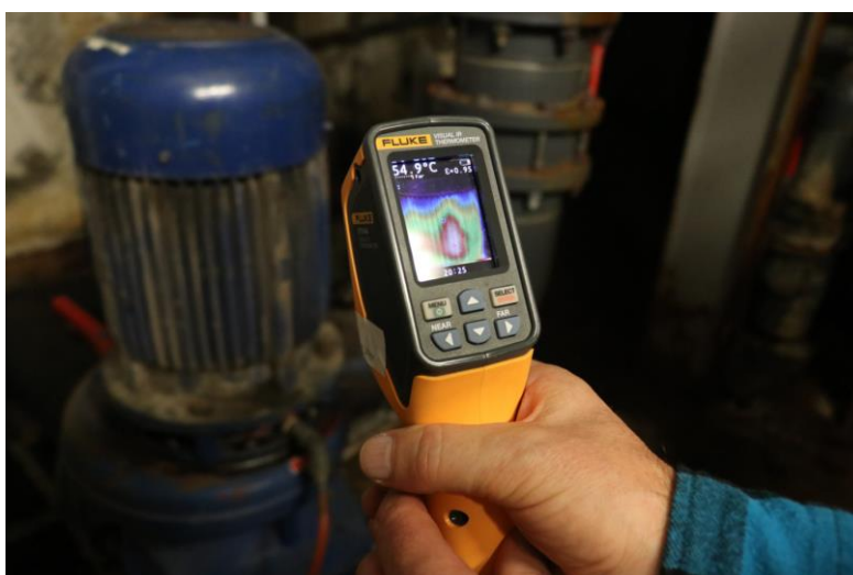
Obr. F-29 Kontrola teploty recirkulačního čerpadla plaveckého 50m bazénu.
