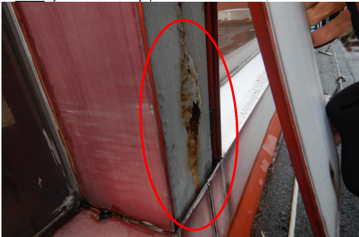
Obr. C-35 Pohled na profil okenního rámu fasády plaveckého 50 m bazénu a projev koroze..
