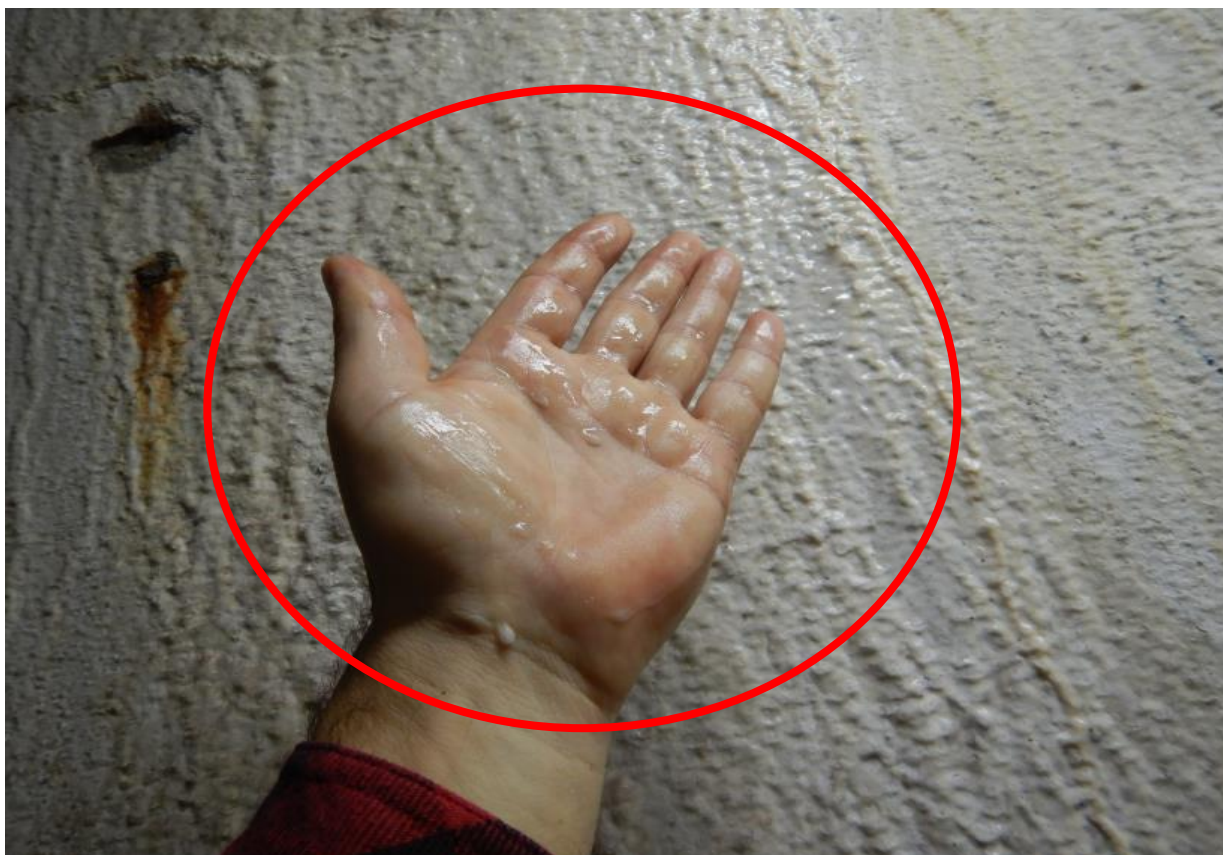
Obr. C-12 Z pohledu na nosnou konstrukci dětského výukového bazénu je patrné průsak vody z bazénu.
