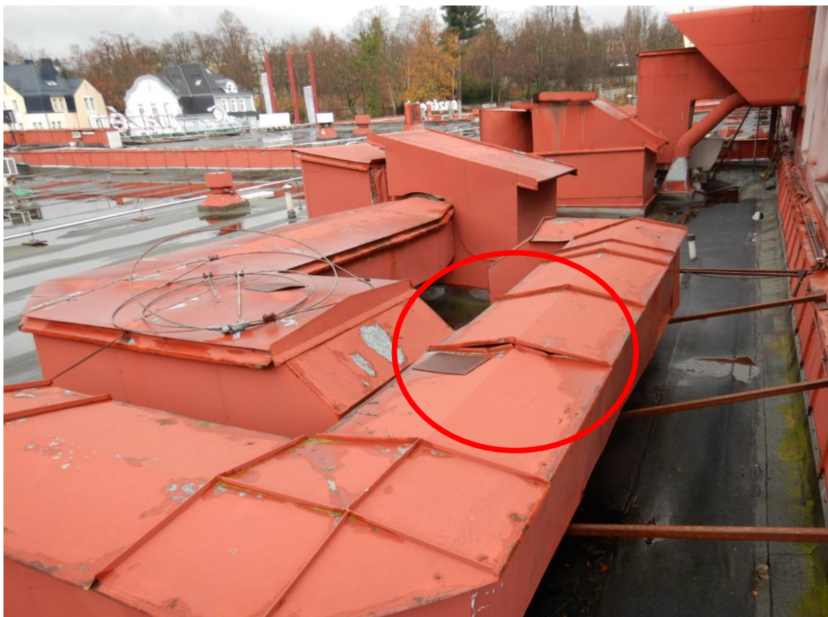
Obr. C-45 Pohled na poškození vzduchotechniky na střeše MPB.
