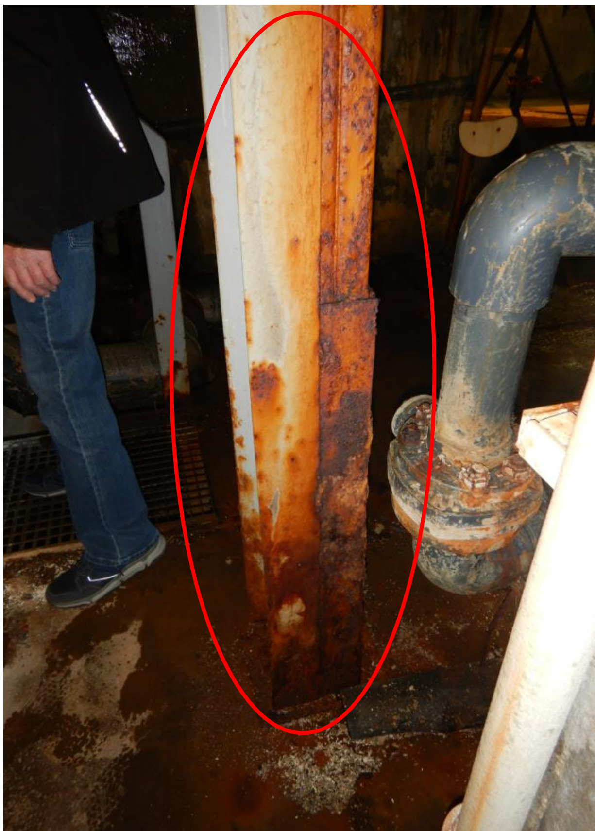
Obr. C-14 Detailní pohled na provizorní podepření dětského výukového bazénu a dna vířivek ocelovou konstrukcí.
