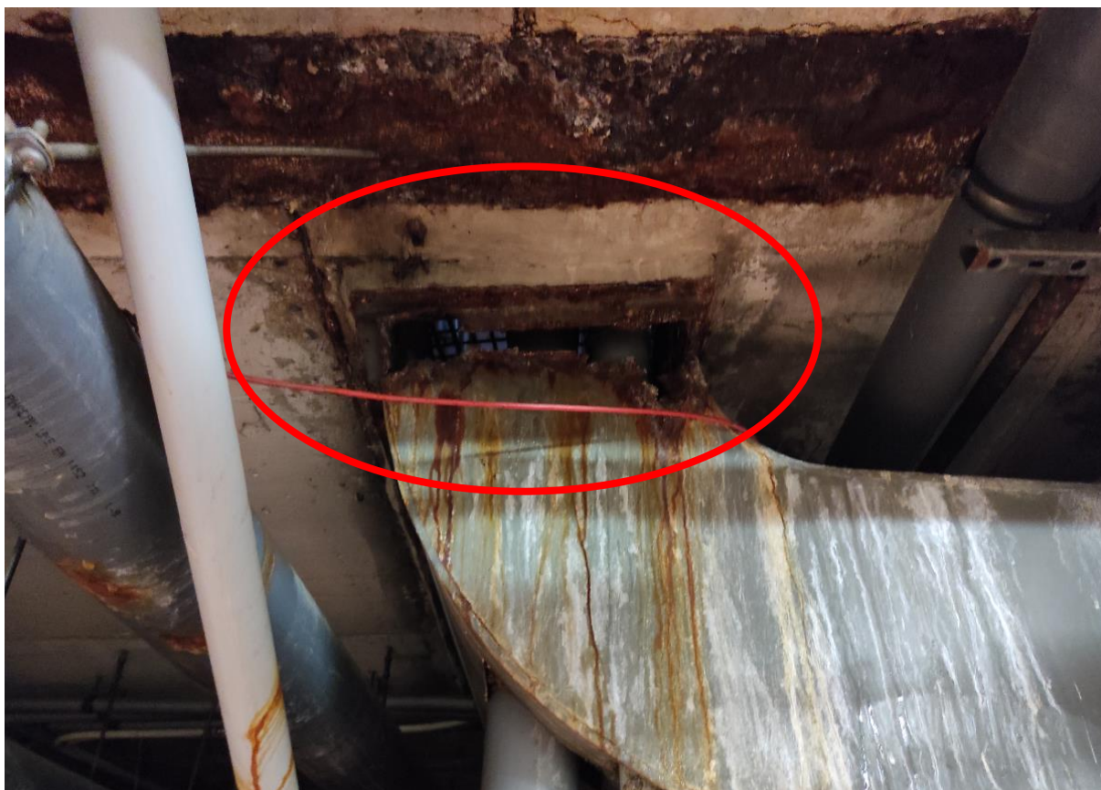
Obr. C-52 Detailní pohled na poškození vzduchotechnických rozvodů rozsáhlou korozi.
