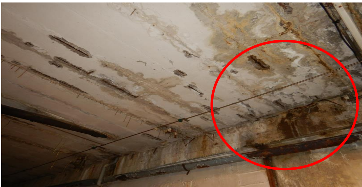
Obr. C-20 Pohled na nosnou vodorovnou železobetonovou konstrukci, do níž zatéká a vykazuje korozi spodní výztuže.
