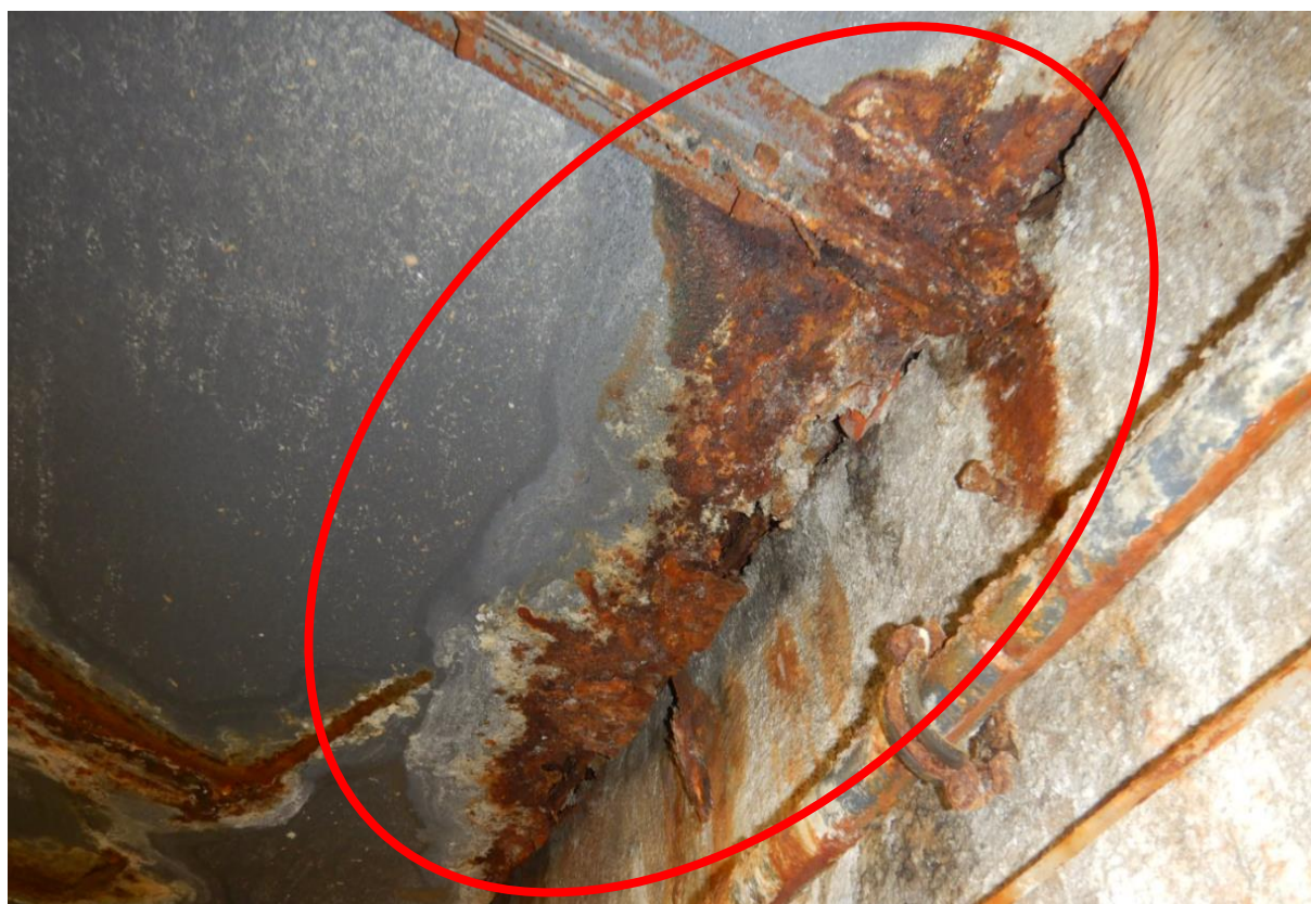
Obr. C-50 Detailní pohled na poškození vzduchotechnických rozvodů rozsáhlou korozí.
