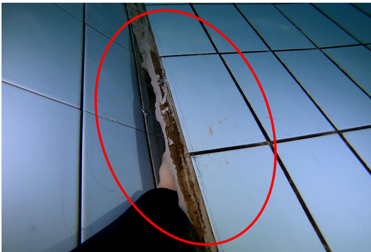
Obr. C-7 Detailní pohled na poškození dna plaveckého 50m bazénu a vznik dutin. Do dutin lze vložit celou dlaň ruky.
