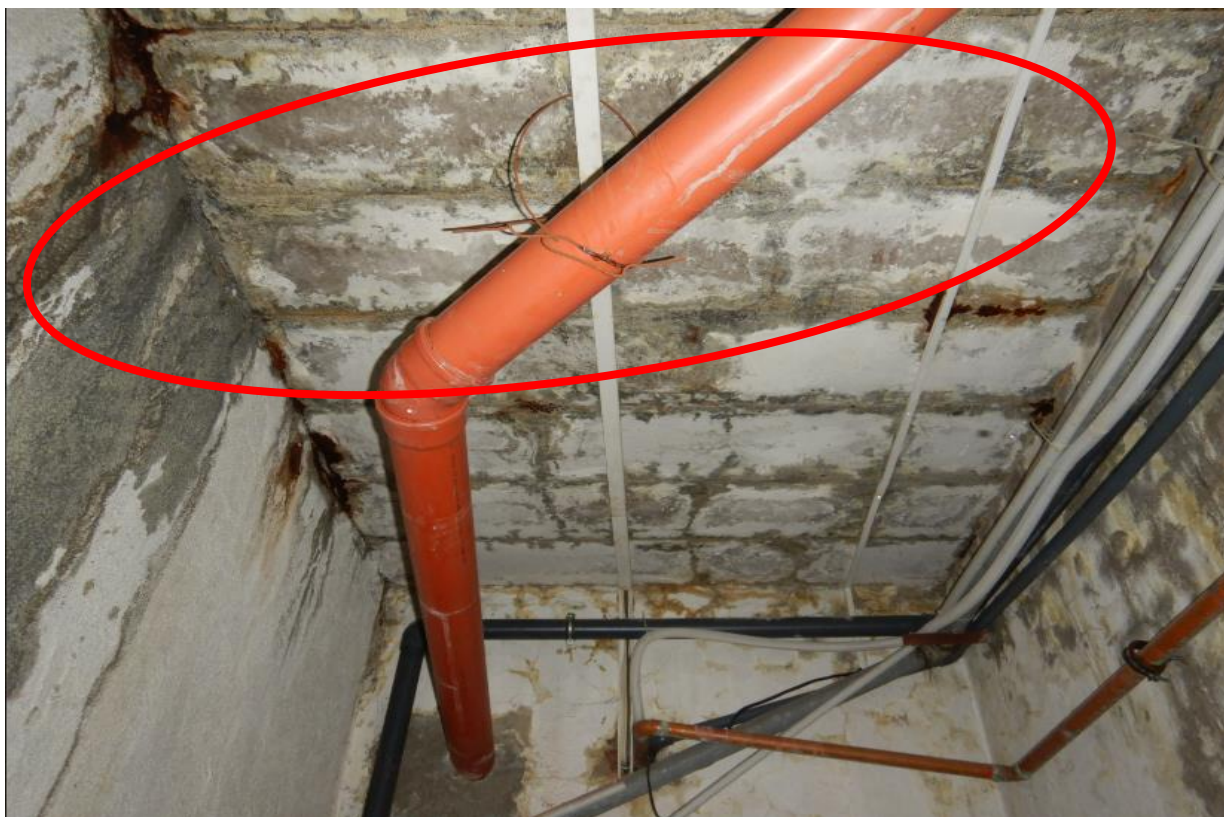
Obr. C-22 Pohled na nosnou vodorovnou železobetonovou konstrukci, do níž zatéká a vykazuje korozi spodní výztuže.
