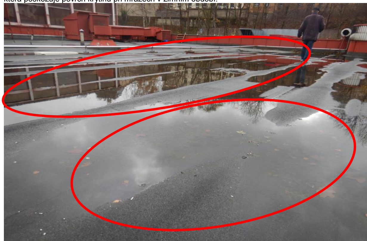
Obr. C-28 Pohled na plochou střechu s patrnými vzduťmi asfaltové krytiny a prohlubní se stojící vodou, která poškozuje povrch krytinu při mrazech v zimním období.
