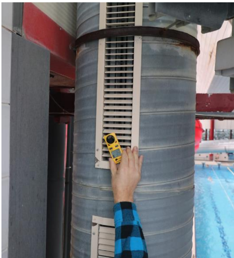
Obr. F-4 Kontrola proudění vzduchu z výdechů vzduchotechniky v prostoru schodiště k tobogánům.
