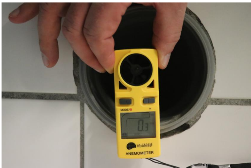
Obr. F-5 Kontrola proudění vzduchu z výdechů vzduchotechniky v prostoru dětského výukového bazénu.
