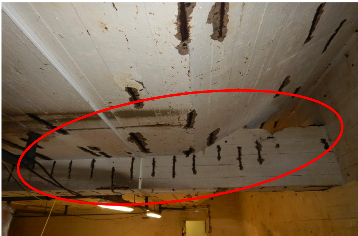
Obr. C-24 Pohled na nosnou vodorovnou železobetonovou konstrukci, která vykazuje korozi spodní výztuže.
