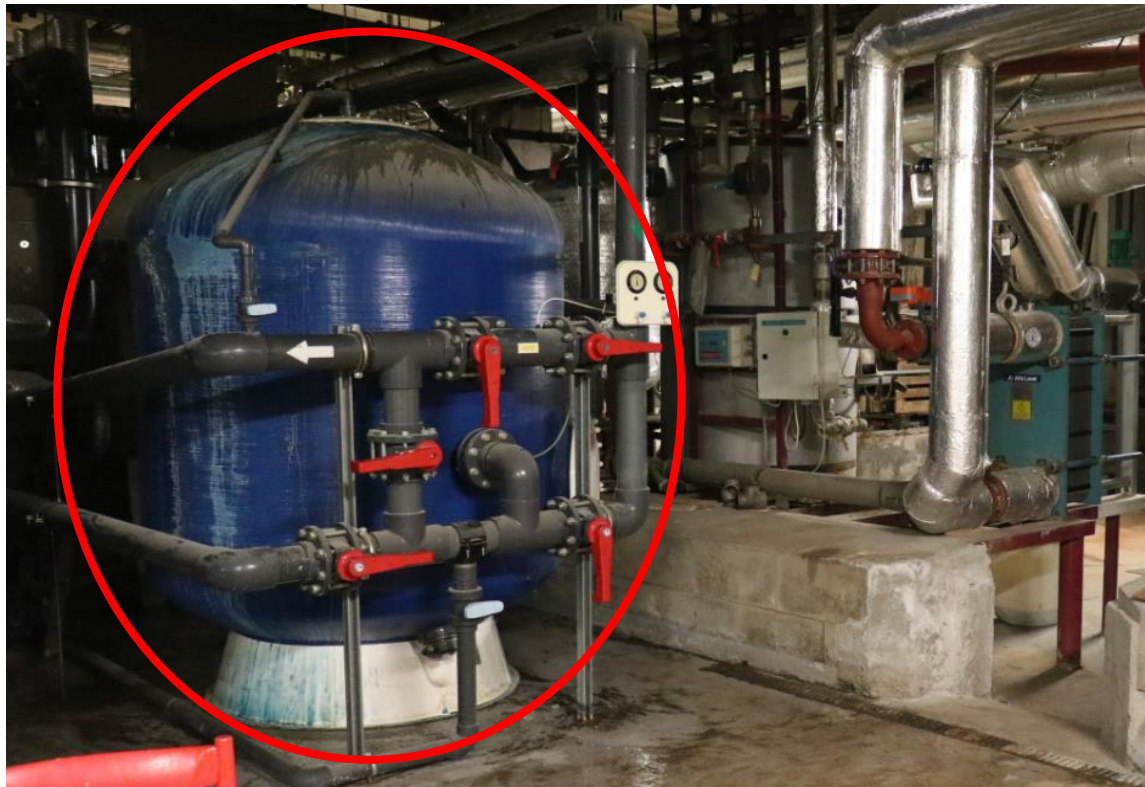
Obr. C-55 Pohled na poškozený filtr plaveckého 25m bazénu.
