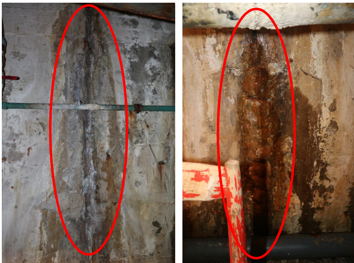
Obr. C-11 Detailní pohled na provedení provizorní opravy plaveckého 50m bazénu v technickém podlaží v místě pod ochozem. Z pravého obrázku je patrný průsak vody konstrukcí bazénu.
