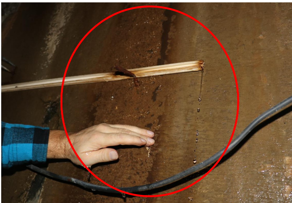
Obr. C-16 Detailní pohled na průsak vody ŽB konstrukcí pod prostorem brouzdaliště.
