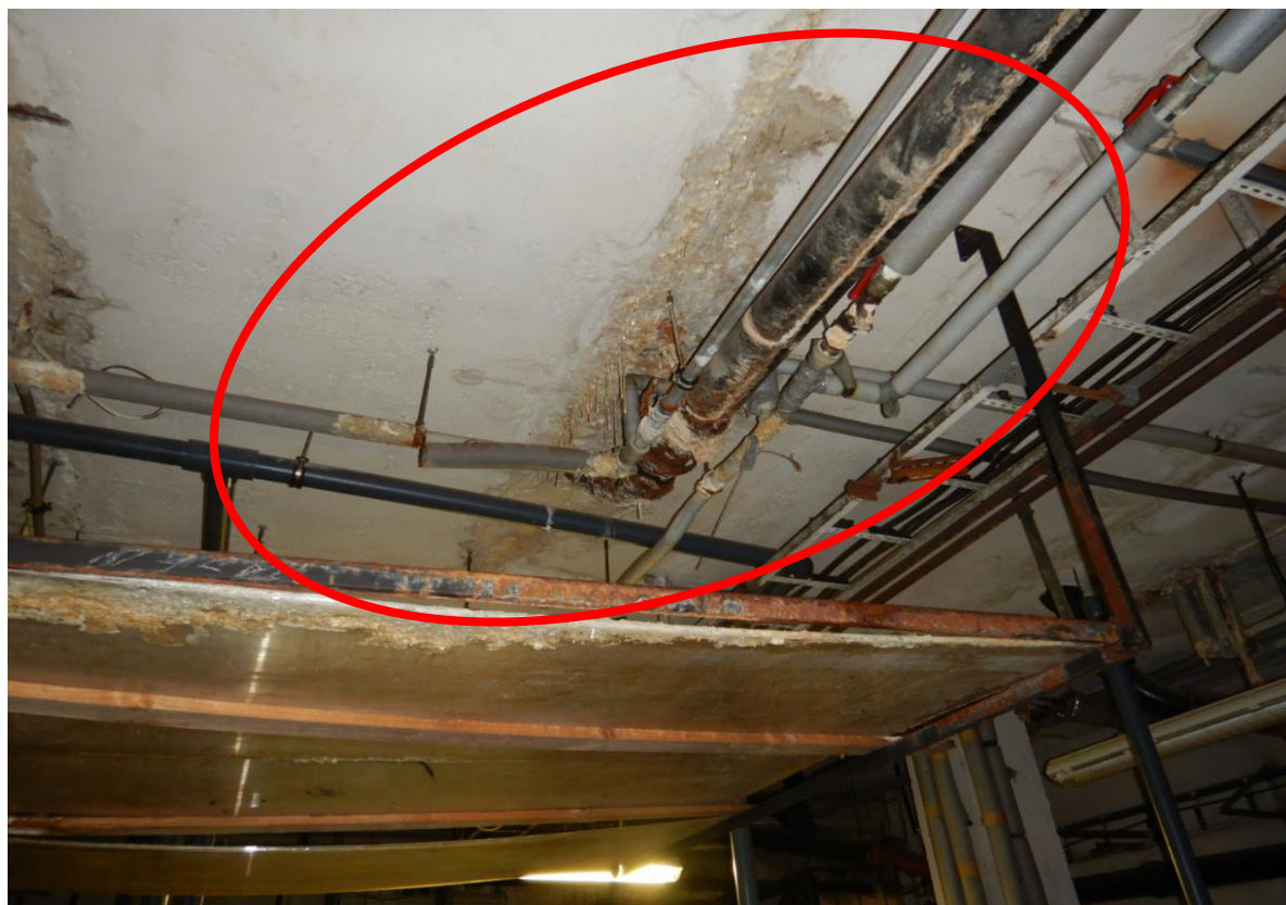
Obr. C-25 Pohled na průsak vody vodorovnou železobetonovou konstrukci z provozních prostor bazénového komplexu.
