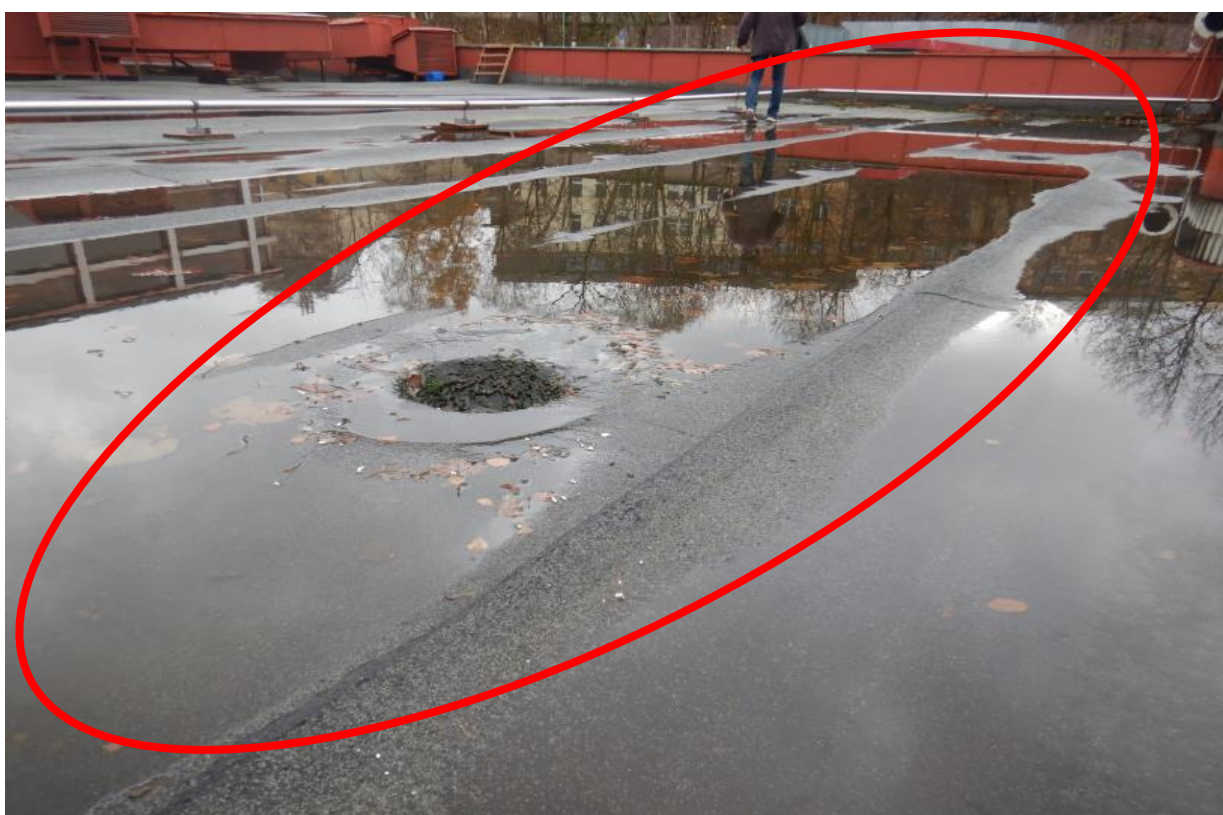
Obr. C-30 Pohled na plochou střechu s patrnými vzduťmi asfaltové krytiny a prohlubní se stojící vodou,
