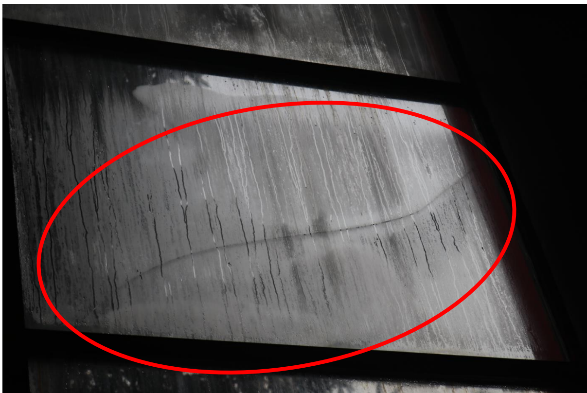
Obr. C-40 Detailní pohled na poškození (prasklinu) prosklené fasády plaveckého 50m bazénu.
