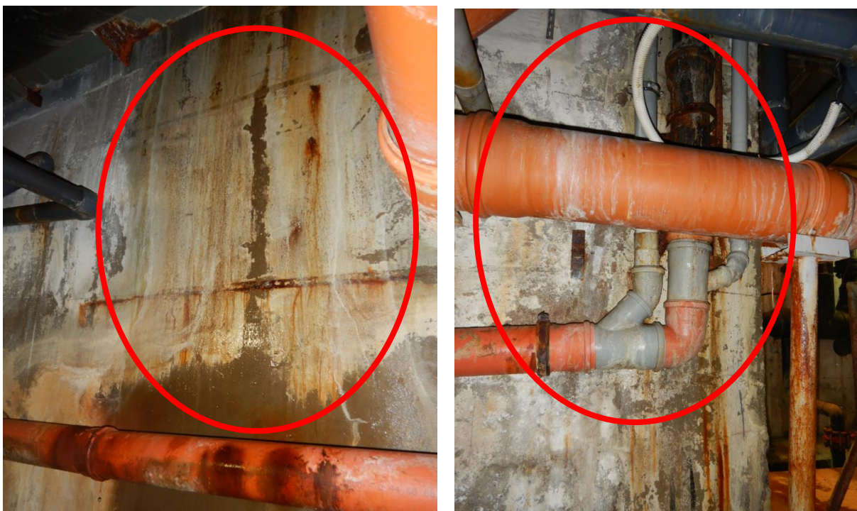
Obr. C-15 Pohled na průsak vody ŽB konstrukcí pod prostorem vřivek.
