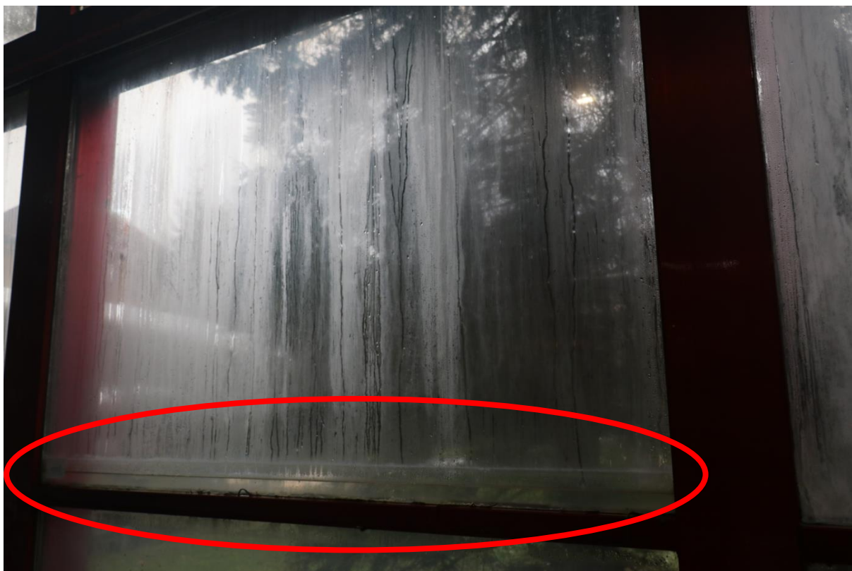
Obr. C-43 Detailní pohled na prosklenou fasádu plaveckého 50m bazénu. Vlivem netěsností dochází k zatékání vody do dvojskla.
